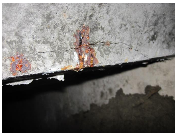
Roest- en scheurvorming
