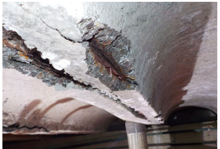
Afgedrukt beton door wapeningscorrosie
