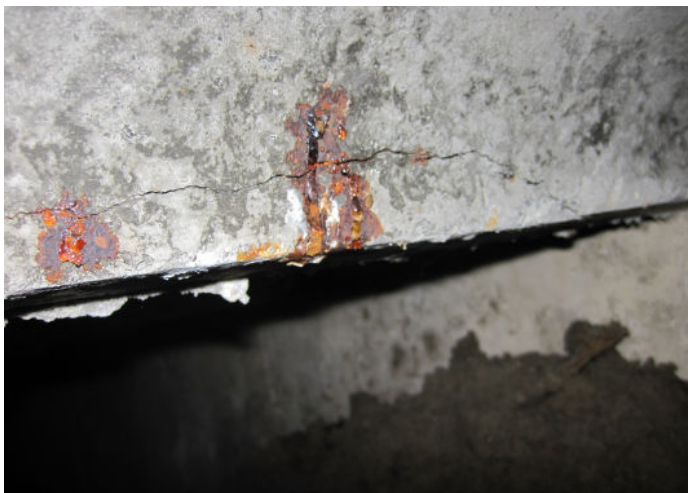
Roest- en scheurvorming
